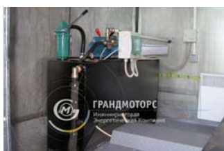
Система автоматической подкачки топлива из внешнего резервуара
